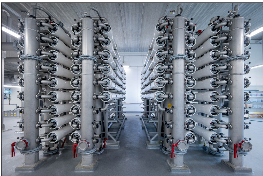
Figur 3.2 Rack vid Kungälv's nya vattenverk - tryckrören innehåller horisontella hålfibers-UF (foto tillhör Kungälv's kommun).
