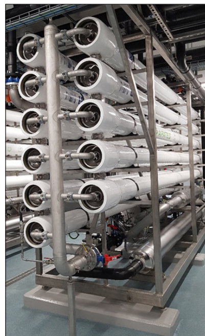
Figur 4.3 RO på Mörbylångas vattenverk (för avsaltning och recirkulering)
