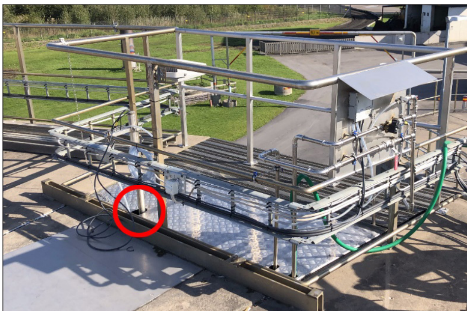
Figur 5.3 Läcka identifierad från DeAmmon kväverening. Kameran användes för att leta utsläpp överallt på taket av byggnaden och luftprover togs vid misstänkta perforeringar, gap vid plattkanter o.s.v. Den röda cirkeln visar platsen för det enda utsläppet som hittades.
