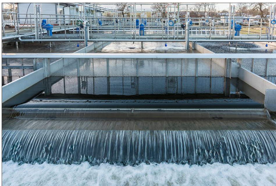
Figur 1.9 Kvävereningen vid Nykvarnsverket.
