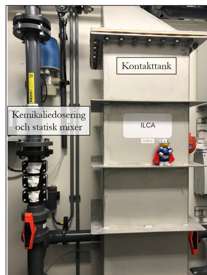
Figur 2.6 Direktfällningen (ILCA) i pilotanläggningen med kemikaliedosering och kontakttank.
