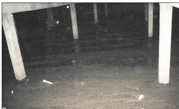
Figur 6.7 Underjordiskt betongmagasin för fördröjning av dagvatten
