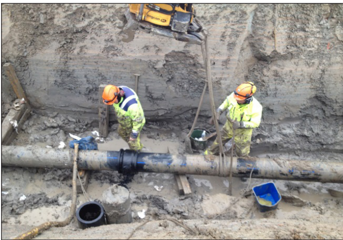
Figur 2.11 Exempel på elsvets vid fogning av två PE100-rör dim. 315 mm. Foto: Mårtensson.
