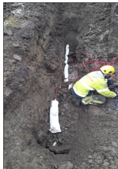
Figur Bilaga 2.3 Zinkanod placerad i en jutesäck med bentonitlera, gips och natriumsulfat placerad nära rörledning (bild J.A Korrosionskonsult).
